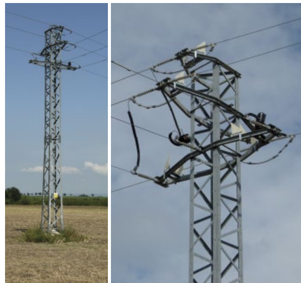
Figure 6 and 7: A very dangerous type of medium-voltage pylon, where a Saker Falcon ( Falco cherrug ) female died in 2011, and the same pylon after applying anti-electrocution elements in 2013 (Biskupice, Prostějov district) (photo: J. Chavko & D. Horal) / Egy rendkívül veszélyes oszlopfajtípus, amelyen egy tojó kerecsensólyom lelte a halálát 2011-ben, és ugyanaz az oszlop a madárbaráttá alakítás után 2013-ban (Biskupice, Prostějov körzet)
