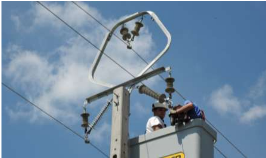
4. kép: Az NKM Áramhálózati Kft. szolgáltatási területén felszerelt első MFK-1 típusú fejszerkezetek egyike a Baksi-pusztán
