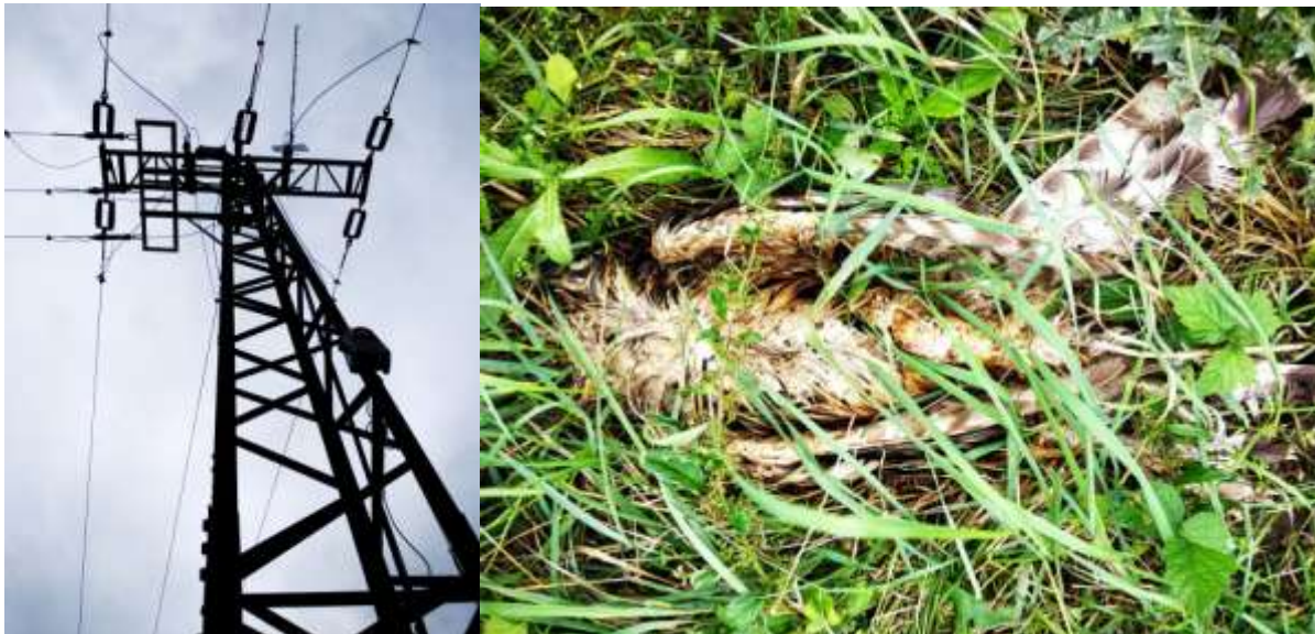
1. kép. A madár pusztulását okozó középvezettségű oszlop és a földön fekvő, áramütött héja
