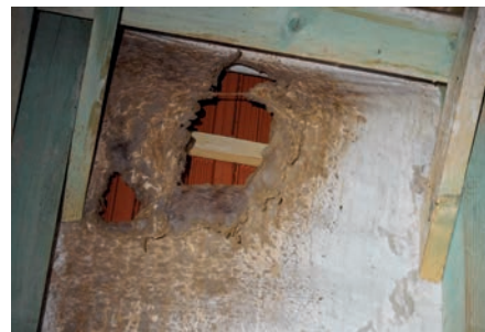
Párazáró fólia két évvel a felhelyezést követően egy közönséges denevér által lakott szálláshelyen, a védelmi célú deszkaborítás kialakítása a pályázat keretében kezdődött meg
